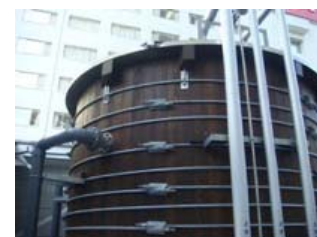
2階外部の設置した受水槽(スギ)
